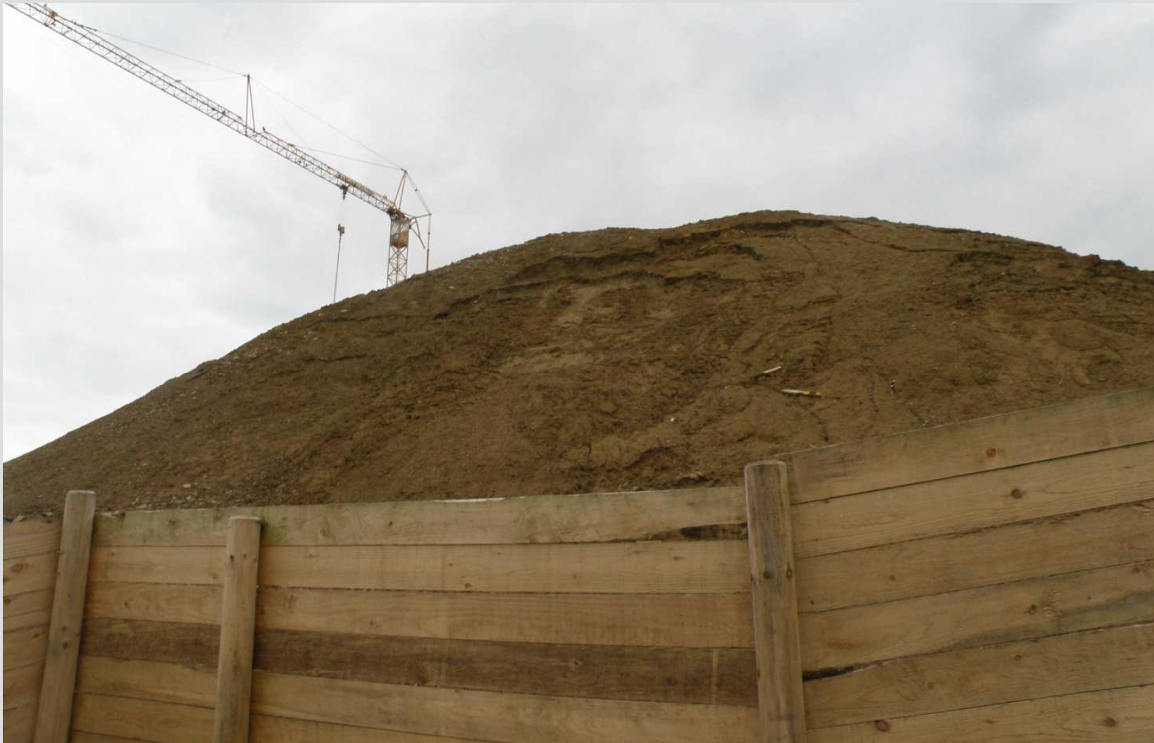
Brückenkopf nach Mutterbodenandeckung, erste Rutschungen
